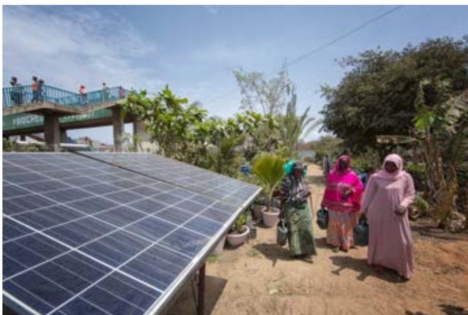
Photo 1 : Exemple de pompe à eau avec système solaire décentralisé, à Dakar, 3 mars 2025
