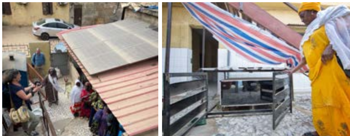
Photo 5 et 6 : Batterie et panneaux solaires installés à Rufisque au GIE Sœurs Jumelles, mars 2025
